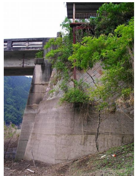
橋台裏にクラックが
