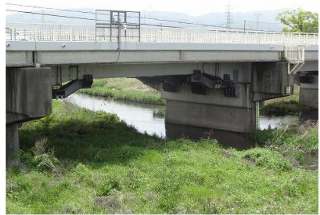
12. 府道「男里川橋」のゲルバー桁には落橋防止装置が付いています
