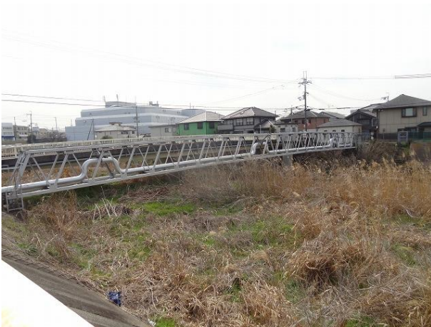
10.管を屈曲させているガス管橋
