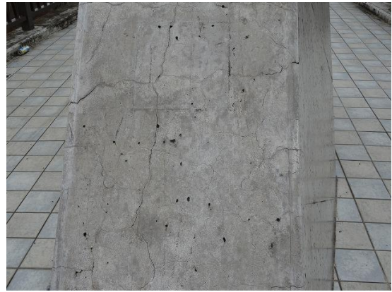
17.アーチのコンクリートにはひび割れがイッパイに
