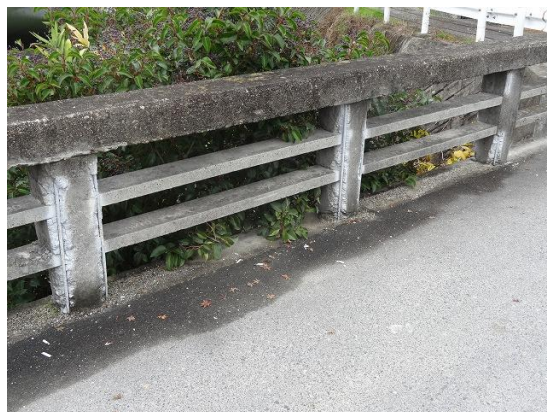
11.高欄の柱の根元の鉄筋を露出させ防錆処置を
