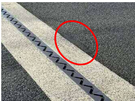
(損傷箇所：①)
