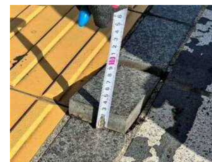
(損傷箇所：③)
