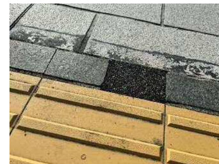
(損傷箇所：⑤)
