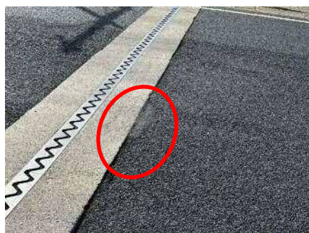
(損傷箇所：①)
