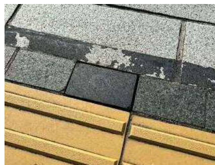
(損傷箇所：②)
