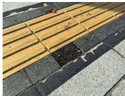
(損傷箇所：④)
