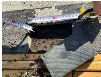
(損傷箇所：②)
