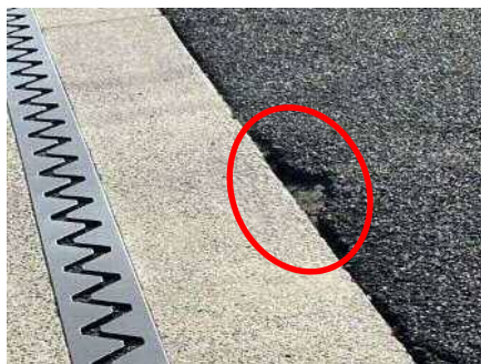
(損傷箇所：①)
