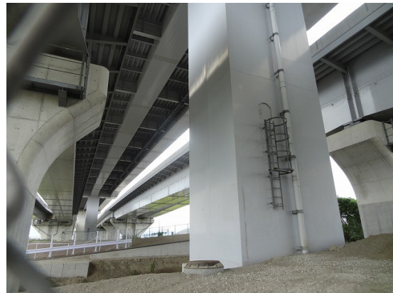
14.本線、オンランプ、オフランプ、一般道の各橋の複雑なこと！
