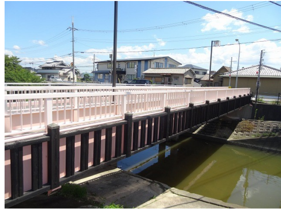
04.歩道橋の桁に木製高欄が
