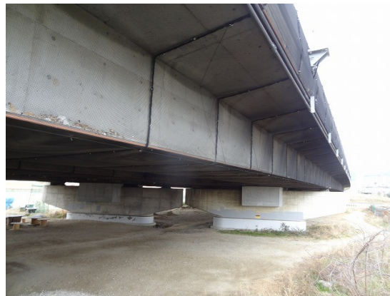
14.コンクリート桁の表面が劣化しだしている
