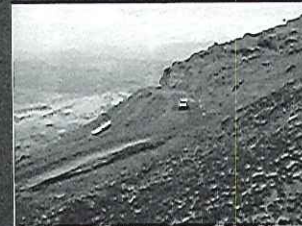
擁壁の崩壊後
